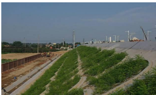
图 6.5-2 路基骨架及灌木防护措施
