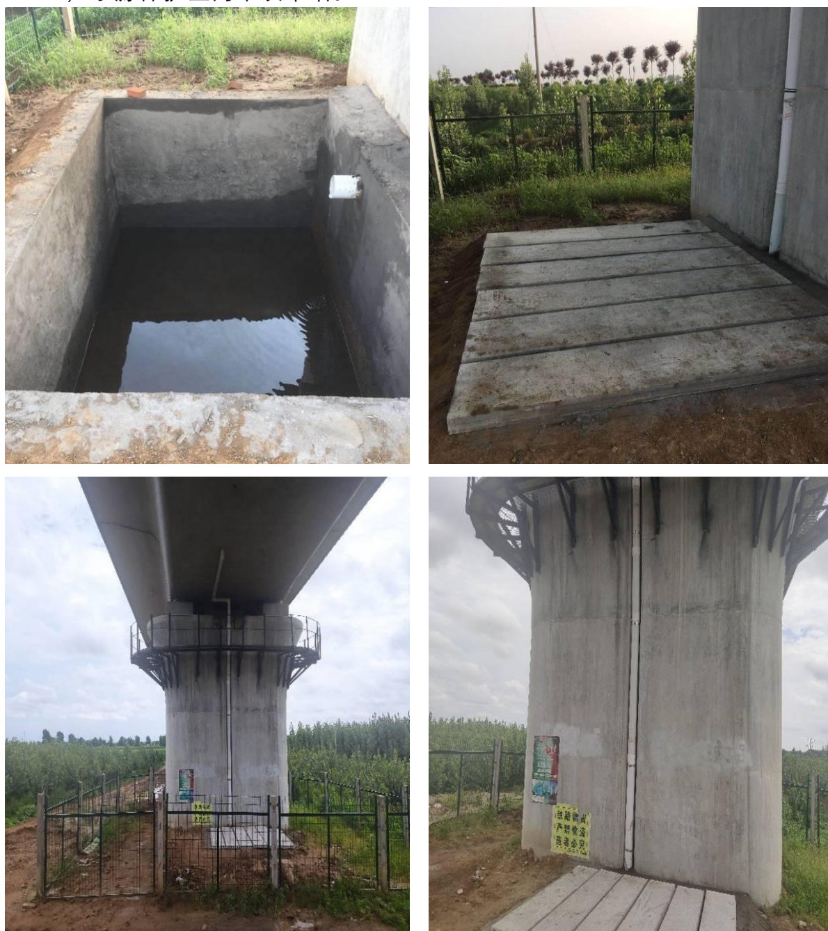
图 9.2-2 昌邑市第二水场水源地保护区集中排水管和集水池
